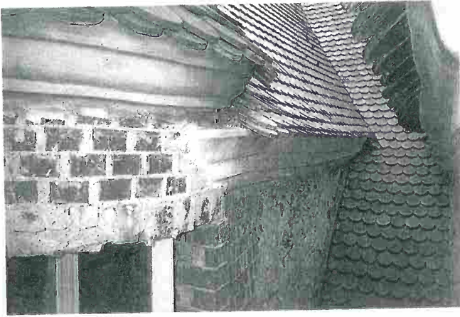
61 Demerthin, Schloss, Bereich zwischen dem westlichen und mittleren Zwerchhaus der Nordseite mit dem instand gesetzten Runderker und der mühevoll geretteten Seitenwand (zur Innenansicht vgl. Abb. 64); Doppeldeckung und geschlossene Kehle; Aufnahme September 1998.
